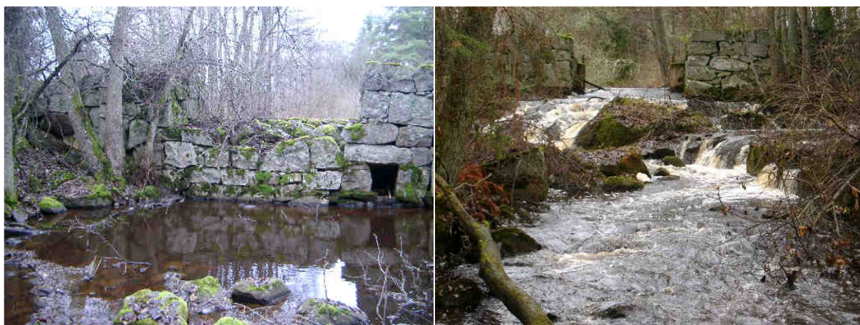
Foto 6. Nykvarn. Södra fåran just nedströms dammen. Kulverten är till höger i bild.
